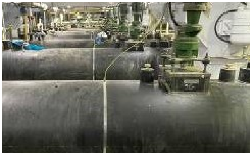
Рис. 1. Каскад полиэтиленовых экстракторов, установленный на площадке бывшего цеха меди
